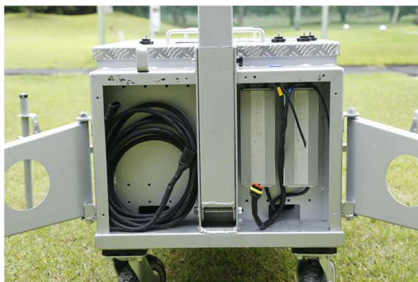
照明用ケーブル（左）と LED 電源（右）
